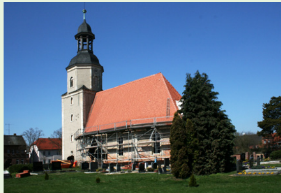
Die ortsbildprägende Kirche in Eutzsch (Landkreis Wittenberg) wird im Rahmen eines Leader-Projektes der LAG Wittenberger Land saniert.
