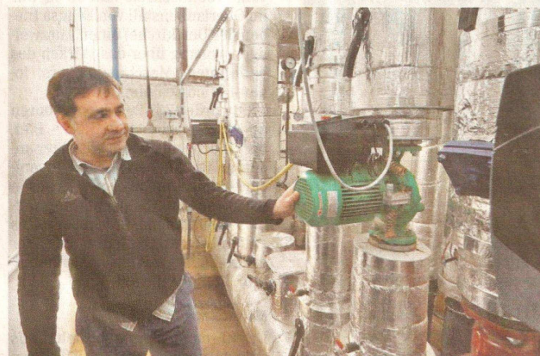
Seydaland-Geschäftsführer Jens Fromm erläutert die Wärmeverteilung an der Biogasanlage. Hier geht das 88 Grad heiße Wasser auf den Weg zu den Abnehmern in der Nachbarschaft.
